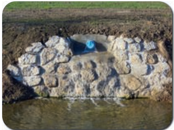
Auslass im Betrieb
