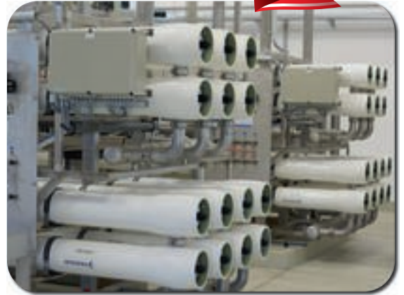
Herzstück der Membranfilteranlage
