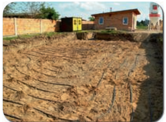
Heizsystem für das Jugendzentrum
