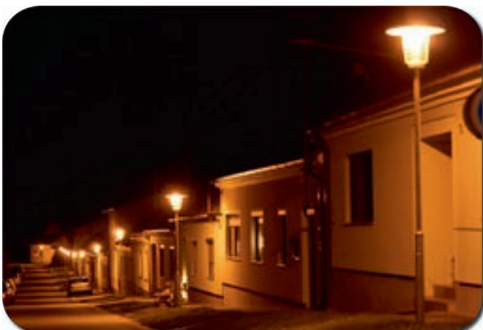
Neue Gasse - neueste LED-Technik
